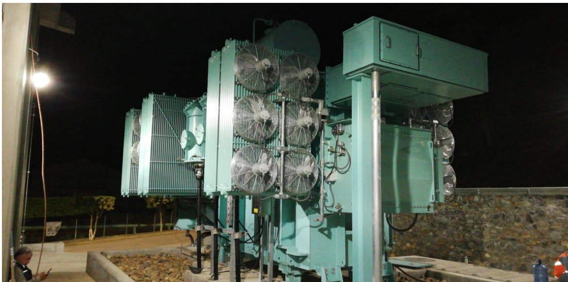
Figura 1.4. Transformador de potencia TR5
