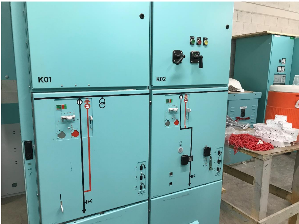
Figura 1.9. Vista frontal de los tableros de las celdas SIEMENS NXPLIS C.
