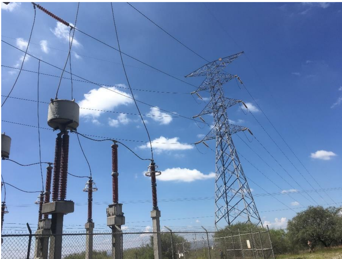
Figura 2.3. Línea de transmisión en 230 kV para alimentación de la planta
