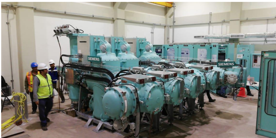
Figura 1.3. Subestación encapsulada de 115kV. Trabajos de puesta en servicio.
