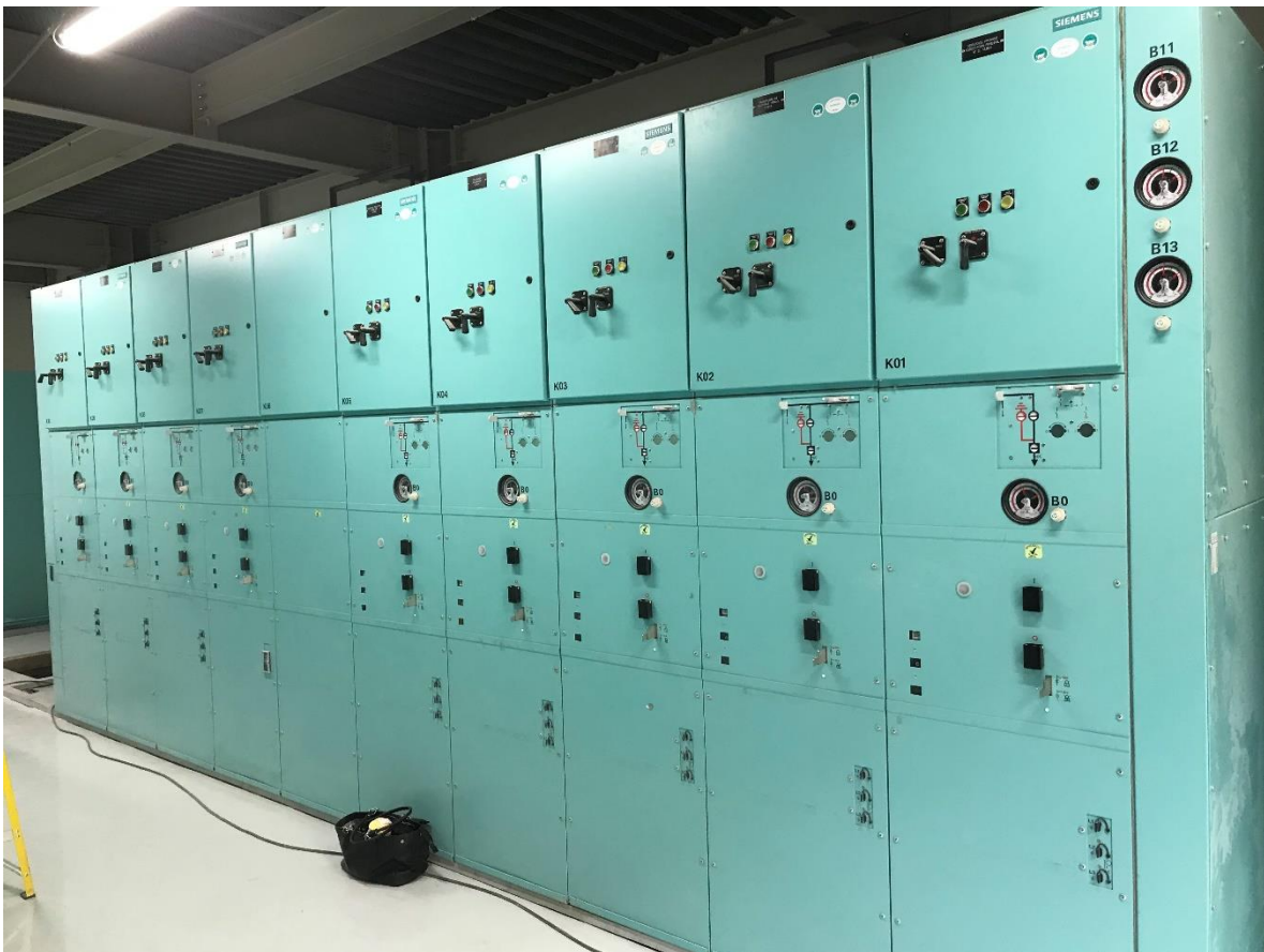
Figura 1.8, Frente de los tableros de interruptores marca SIEMENS tipo 8DA10.
