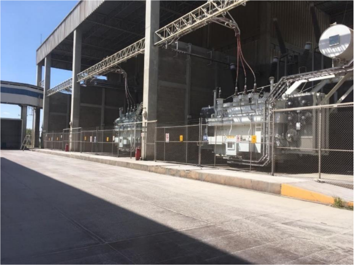
Figura 2.4. Transformadores de potencia 230/85 kV acometida principal de la subestación Cruz Azul.
