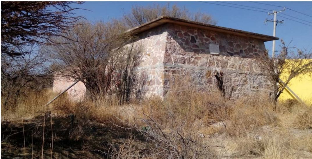
Figura 3-6 Tanque de agua.
