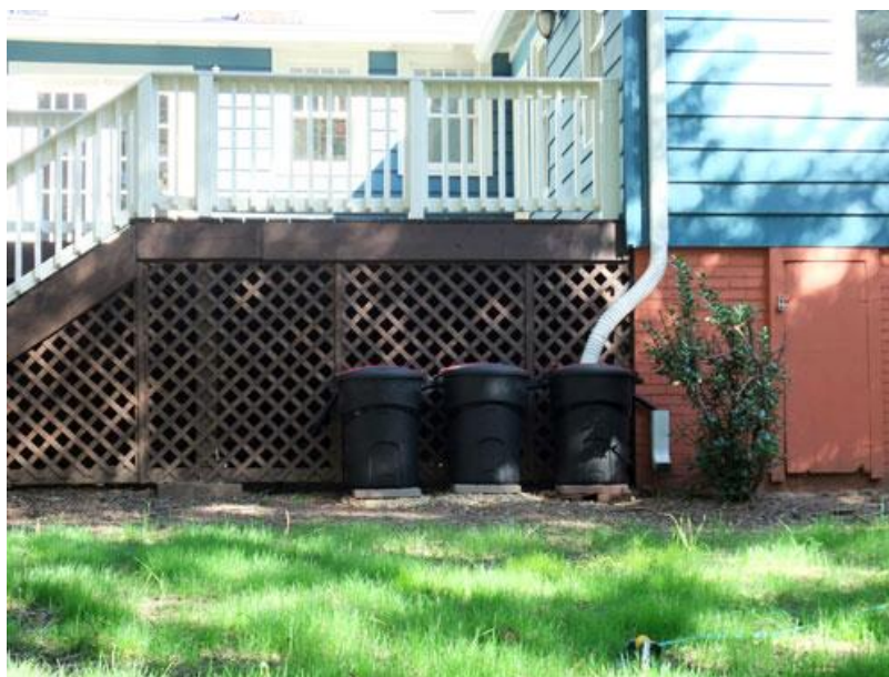
Figura 1.50 Sistema familiar de captación de agua de lluvia en Texas, USA
