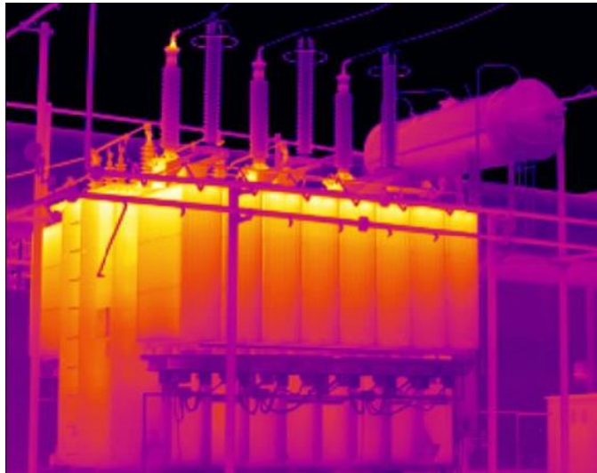
Figura 3. Imagen térmica de un transformador [20].
