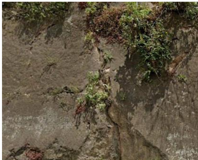
Figura 4.35: Grietas de tensión en el talud de Xoloco
