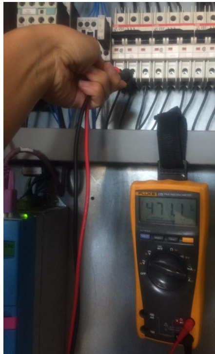
Figura 18. Voltaje en terminales de alimentación de variador de velocidad.
