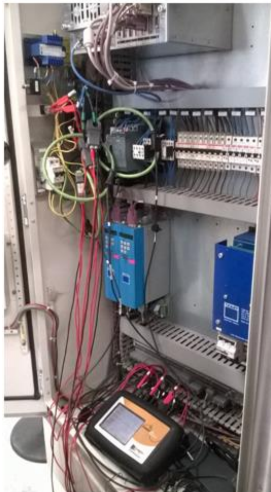
Figura 7. Instalación de equipo de medición.
