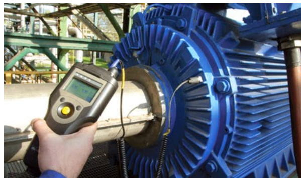
Figura 2: Motor de inducción con sensores para análisis de vibración
