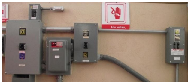
Fig. A. 1 Interruptores.
