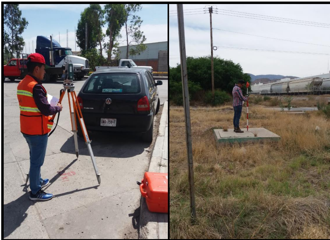
Figura. 8 Levantamiento topográfico de los puntos de interés de la red de distribución.
