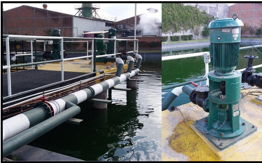
Figura. 20 Estación de bombeo en Eje 104.
