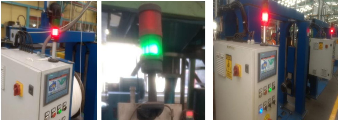
Ilustración 45. Sistema de semáforos de estatus de la máquina. Fuente: Elaboración propia
