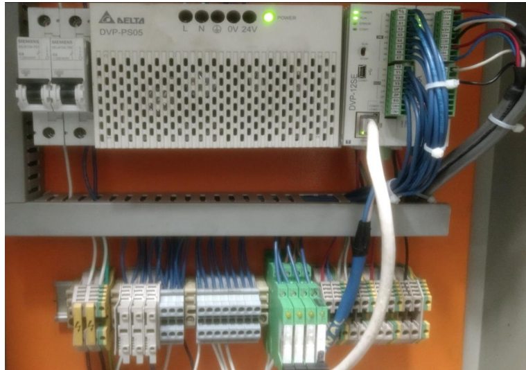
Ilustración 35. Integración de PLC “DELTA®” para la obtención de variables de procesos. Fuente: Elaboración propia.
