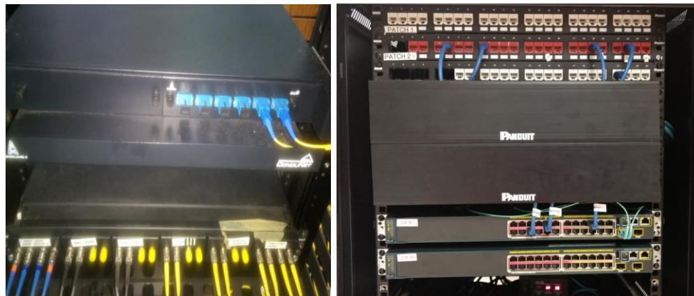
Ilustración 11. Equipo de interconexión de fibra y cobre en los sitios de planta. Fuente: Elaboración propia.
