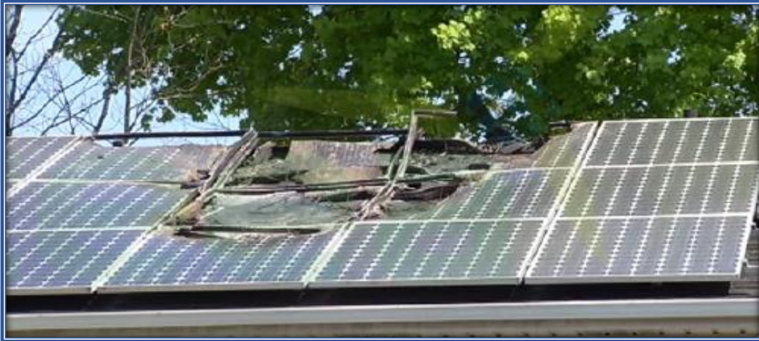
Figura 10. Sobrecalentamiento de los paneles solares por sombra.
