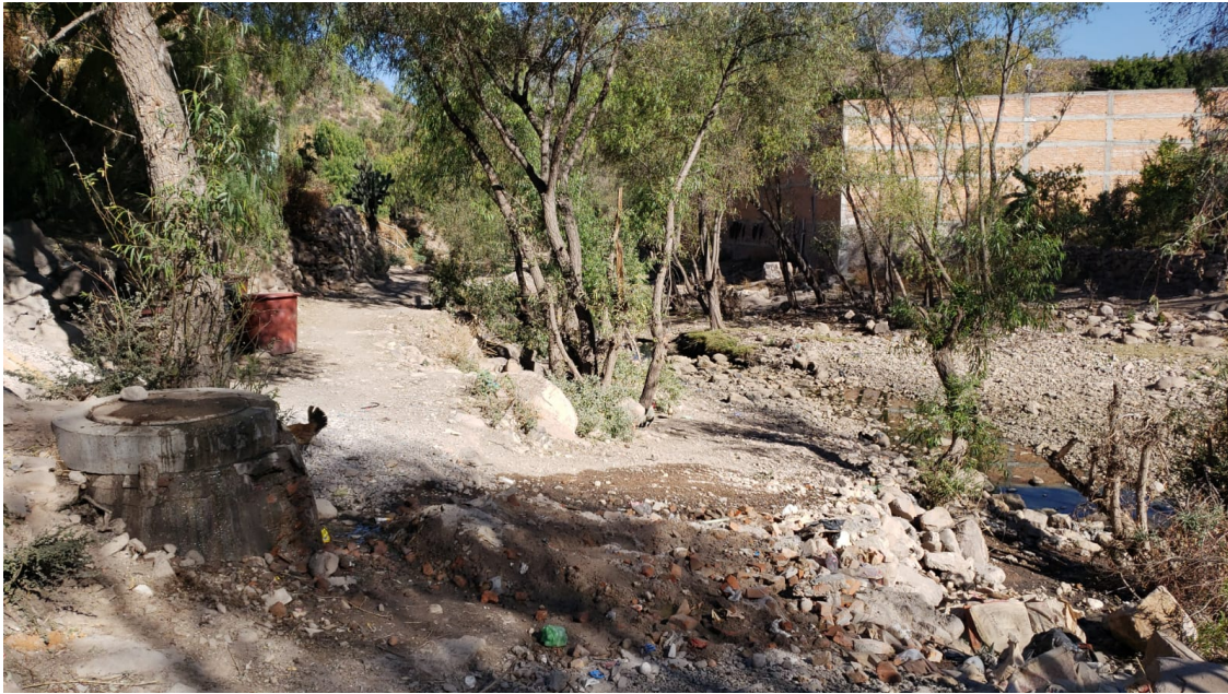
Figura 3-25 Drenaje colapsado en la localidad de Escalerillas
