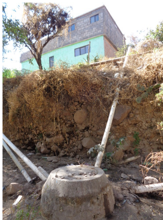
Figura 3-24 Estado actual de los pozos de visita
