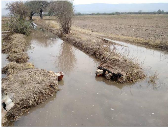
Figura 14 Camino de terracería dañado por filtraciones de agua del canal
