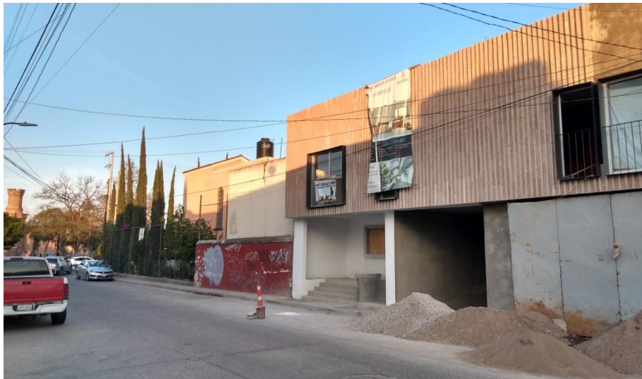
Figura 15: Complejo departamental residencial aún en la fase de construcción, donde al fondo de la imagen se puede apreciar la entrada del Centro de las Artes de San Luis Potosí.
