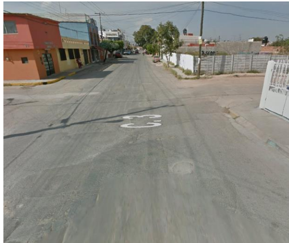
Figura 25: Cruce la Calle 3 con la Calle 14 en la colonia Industrial Aviación, donde son altamente visibles las consecuencias de la falla geológica sobre el pavimento de la vialidad, incluso en las banquetas.
