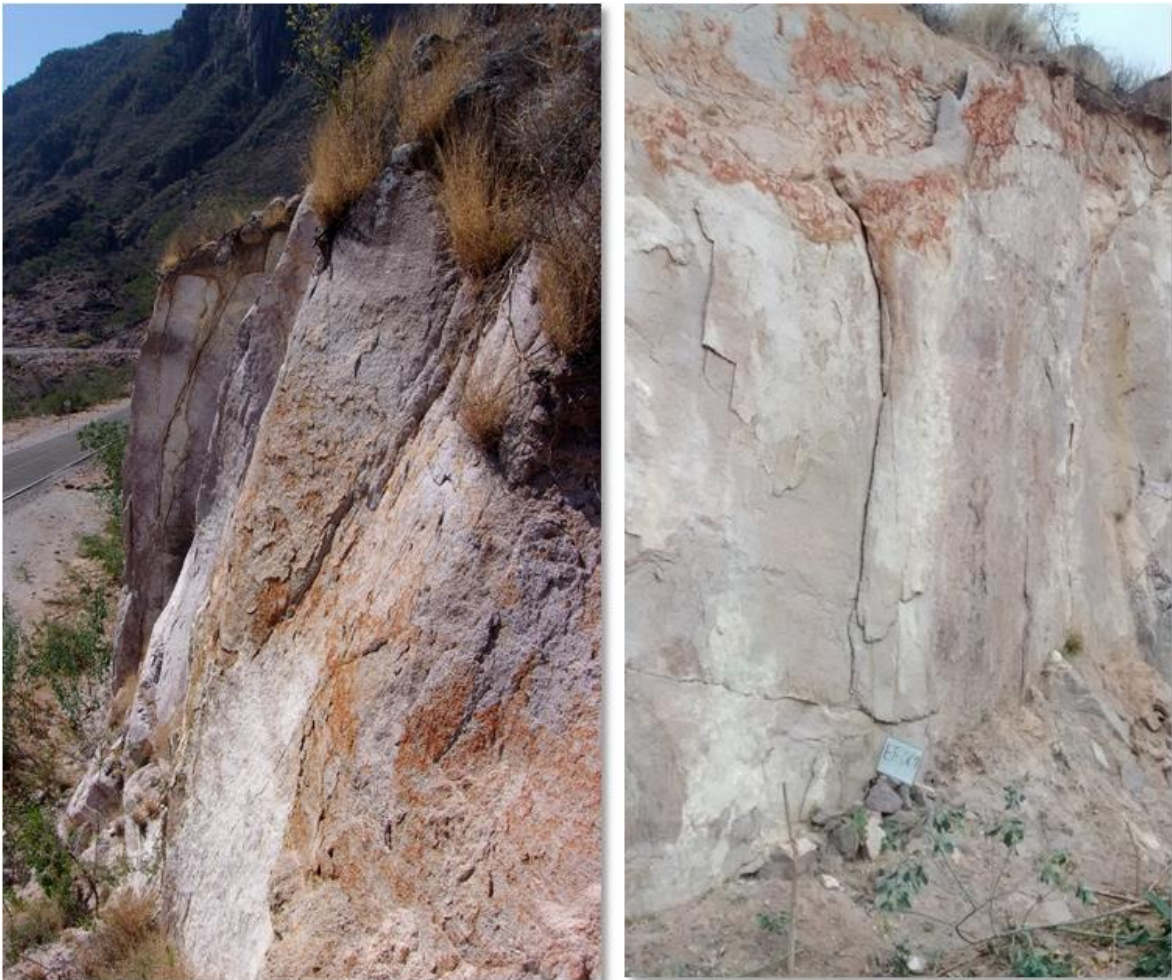
Figura 59.- Bloques tendientes al colapso por pandeo y vuelco.
