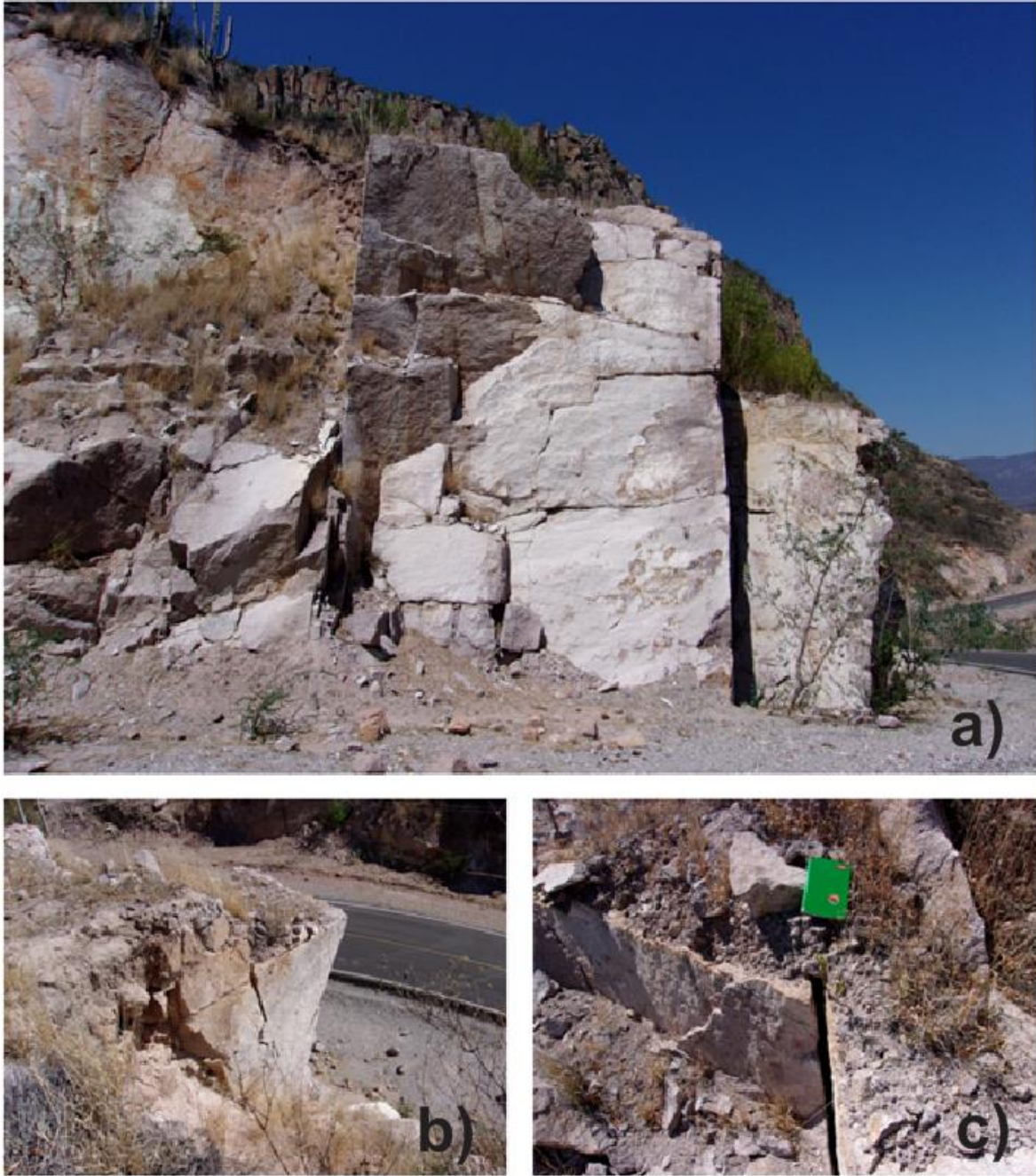
Figura 50.- Deslizamiento planar en talud 3, estación ER-009, en la imagen a) observamos una imagen general del talud, en la figura b) la grieta que corre casi hasta la base con un alto grado de rugosidad y en la figura c) la apertura de la grieta de tracción.
