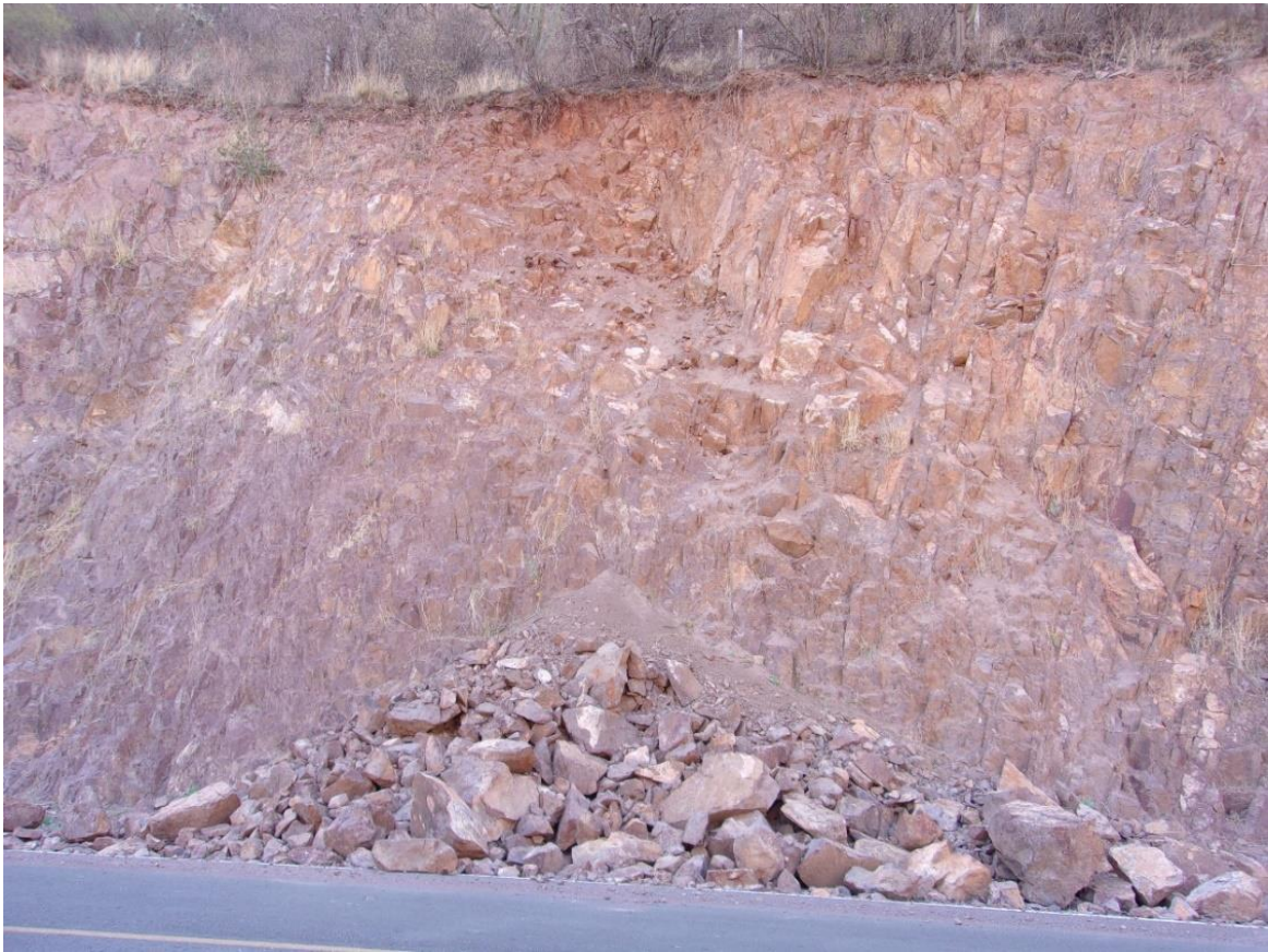
Figura 47.- Deslizamiento en cuña en el talud 1, estación ER-002.
