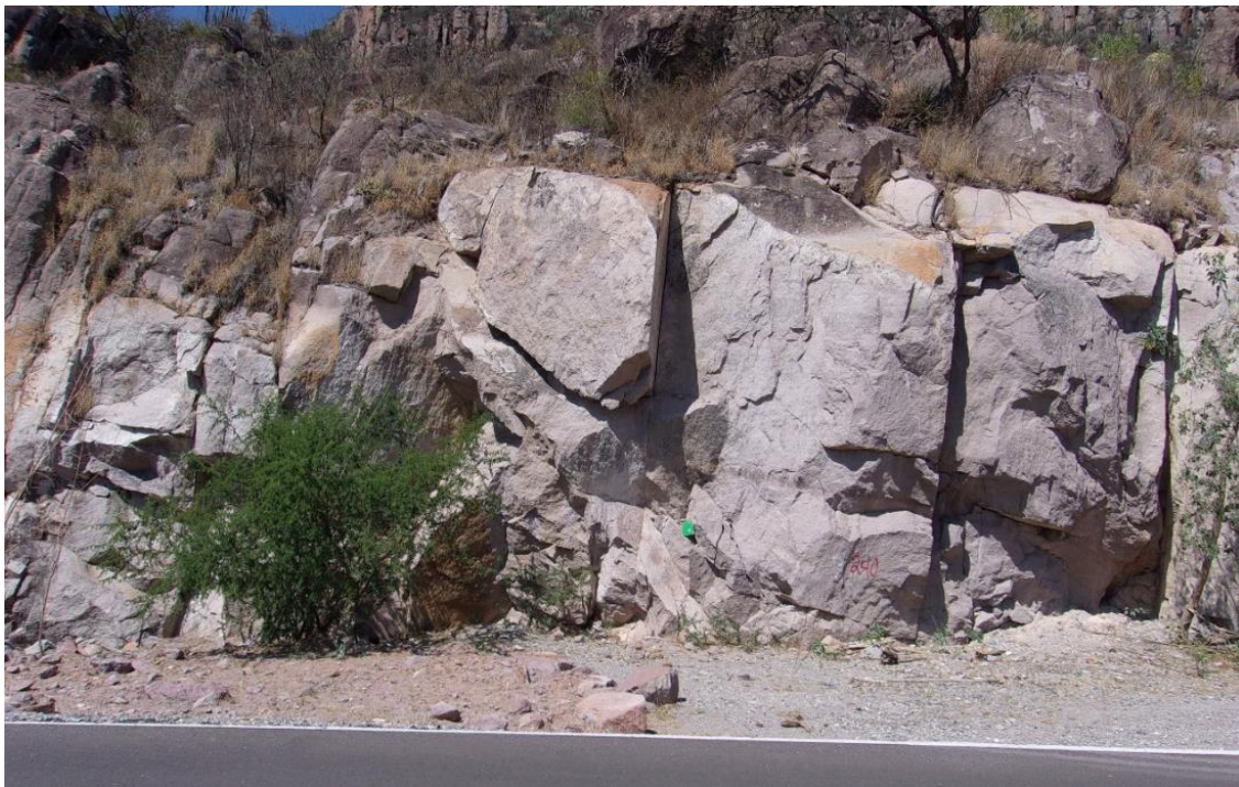
Figura 49.- Cuña en talud 2, estación ER-009 donde una de las familias redirige el esfuerzo del bloque sobre la roca del talud generando una condición de estabilidad.
