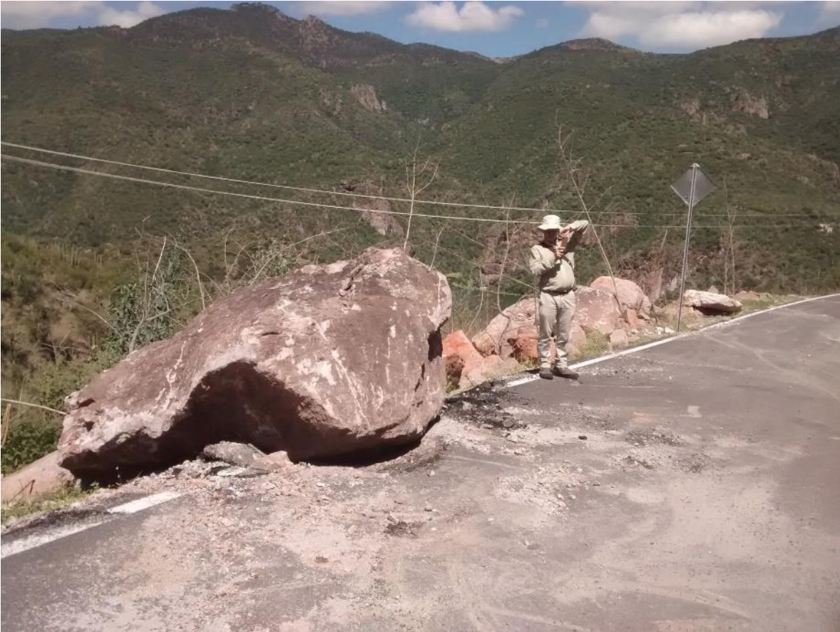
Figura 24.- Bloque de gran tamaño caído en zona de brecha en la carretera Tierra Nueva- El Realito cuyo impacto y remoción manual daño la zona de asfalto.
