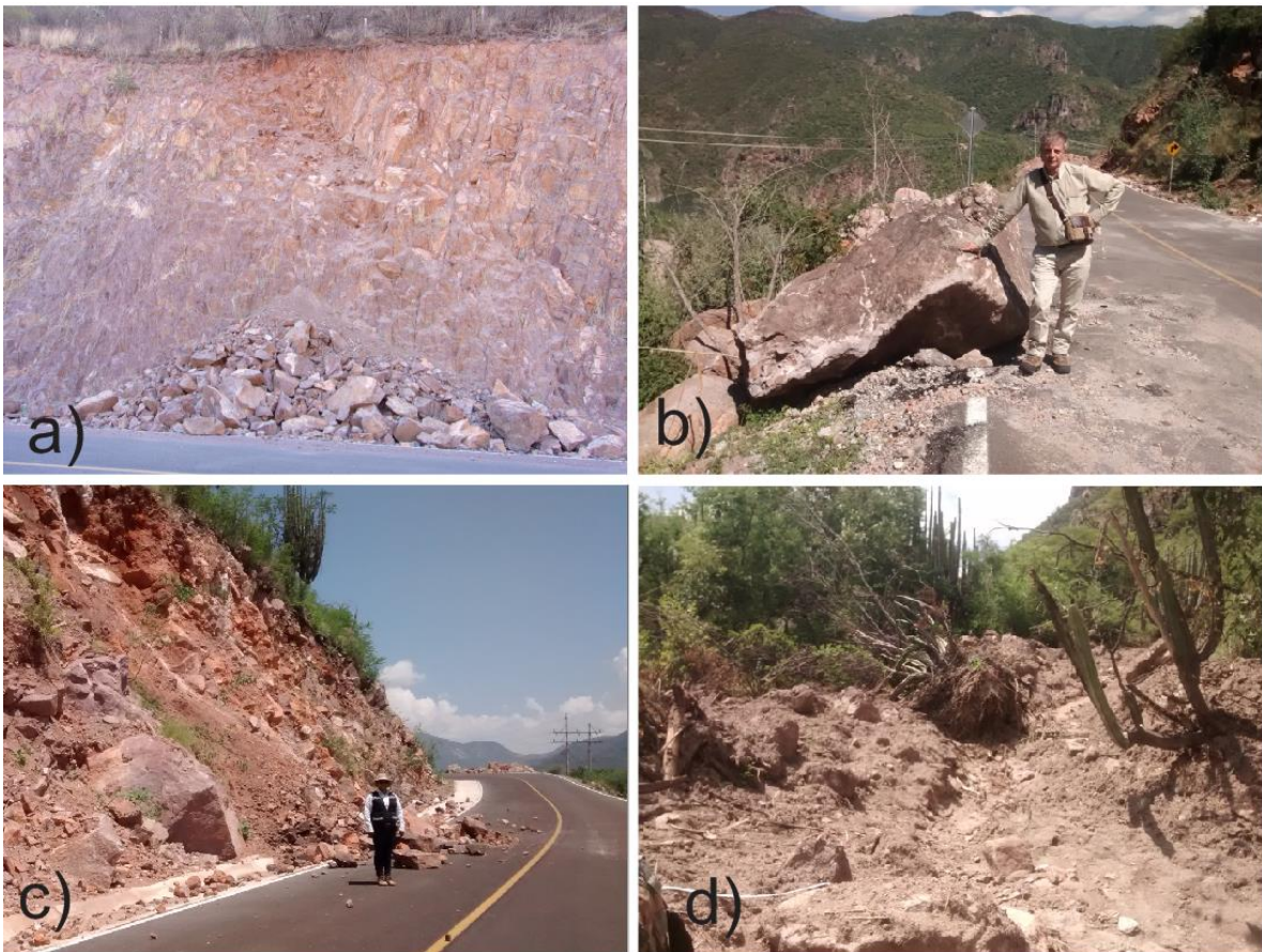
Figura 20.- Diferentes mecanismos de falla que se han presentado en el tramo carretero: a) deslizamiento en bloques, b) caídos, c) deslizamiento de tierra, d) flujo de escombros.
