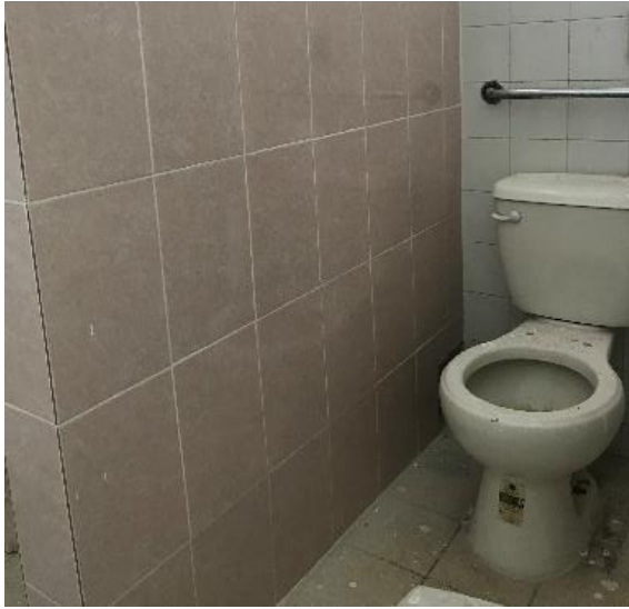
Figura 6.1 Baños de bajo consumo de agua.
