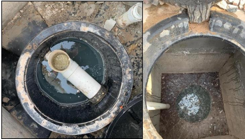
Figura 15. Izquierda: Acumulación de GyA en biodigestores actuales. La imagen de la derecha representa un biodigestor obstruido. Se necesita trampa GyA como tratamiento preliminar.
