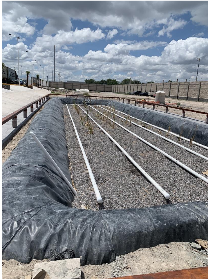
Figura 28. Sistema de distribución de tuberías.
