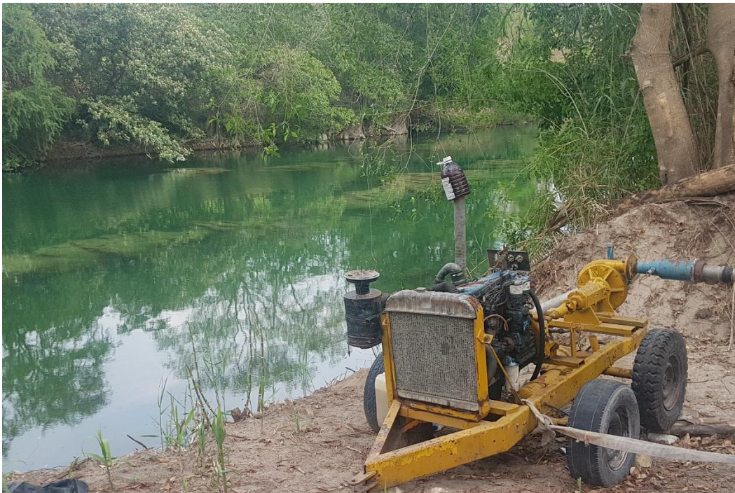
Figura 6.1.- Bomba casera fabricada con motor diésel y turbina.
