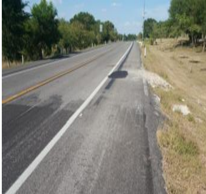
Figura 4.- Estado actual del Pavimento bacheo profundo, Segmento 2 del km 100+000 al km 118+640.
