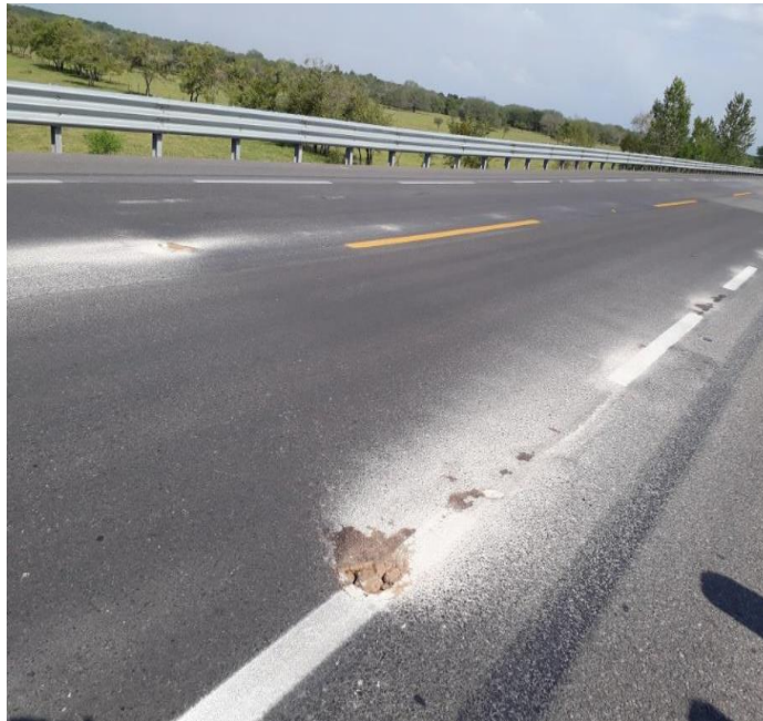
Figura 5.- Estado actual del Pavimento bacheo profundo, Segmento 2 del km 100+000 al km 118+640.
