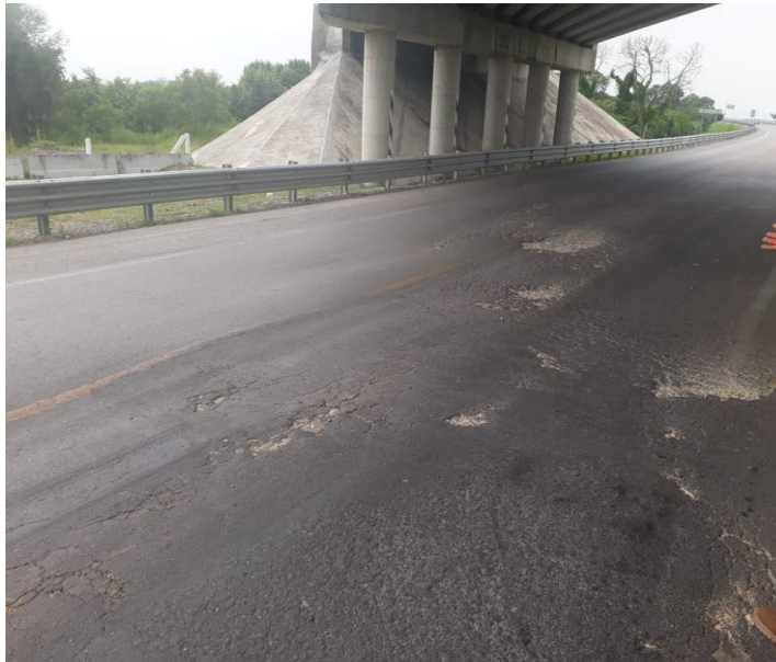
Figura 7.- Estado actual del Pavimento Fisuras Longitudinales y Transversales bacheo profundo, Segmento 2 del km 100+000 al km 118+640.
