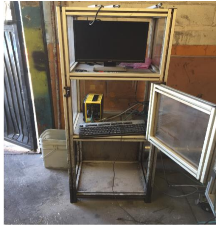
Figura 54. Estación de control. Fuente: Elaboración propia.
