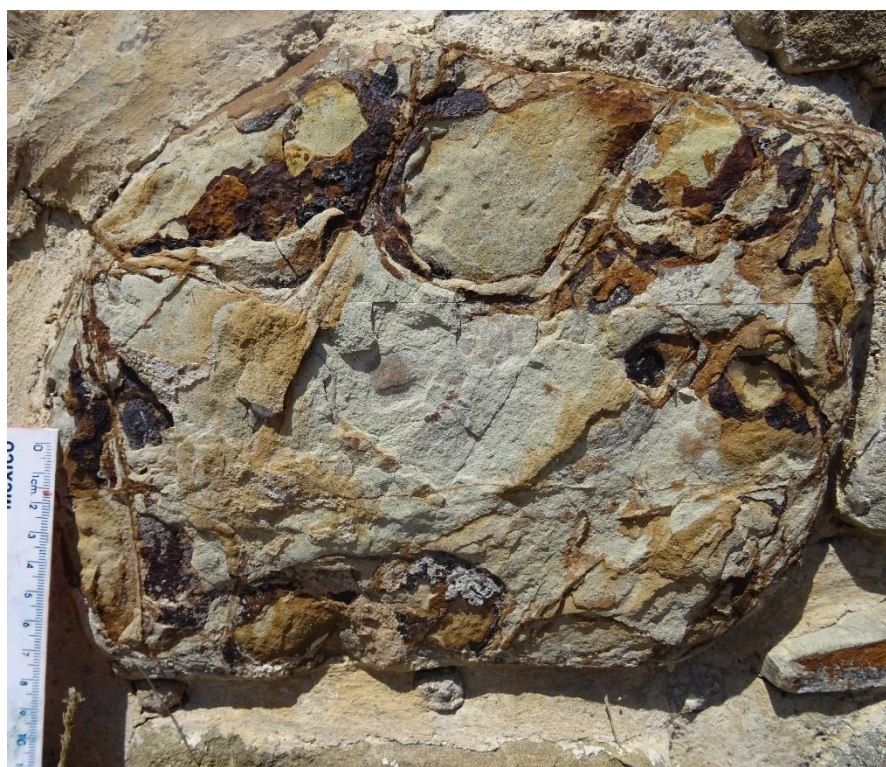
Figura 10. Roca perteneciente al edificio D altamente dañada, presentando delaminación
