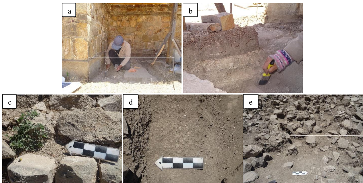
Figura 44. Recolección de muestras de morteros originales tomadas de la fachada sur en el edificio VG: a) Pozo 4 en alfarda sur, b) pisos encontrados en el pozo 4, c) juntas correspondientes al segundo cuerpo de la fachada sur, d) firme correspondiente al segundo cuerpo de la fachada sur y e) zona de excavación en la fachada sur donde se pudo obtener un núcleo de tierra.
