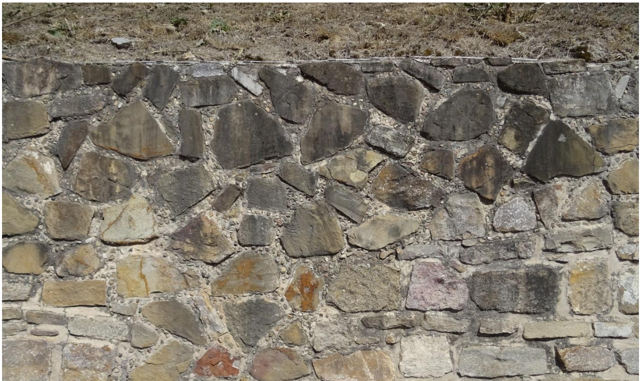
Figura 11. Parte de la fachada oeste del edificio D en la zona arqueológica de Monte Albán, en donde se puede observar las costras negras incrustadas en las rocas de la parte superior de la estructura.
