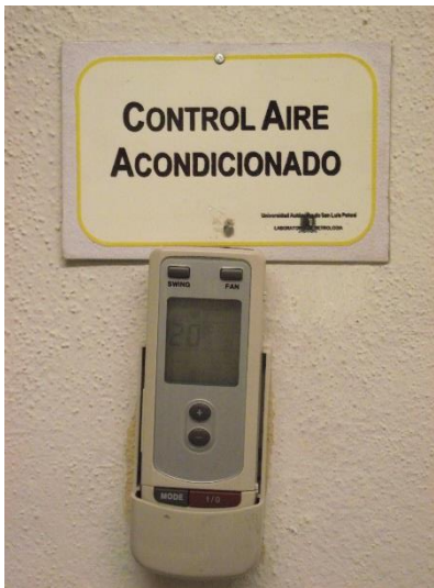
Figura 5.13 Control de aire acondicionado.
