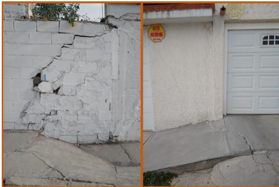
Figura 77. Casas afectadas en Industrial Aviación, Falla Aeropuerto.
