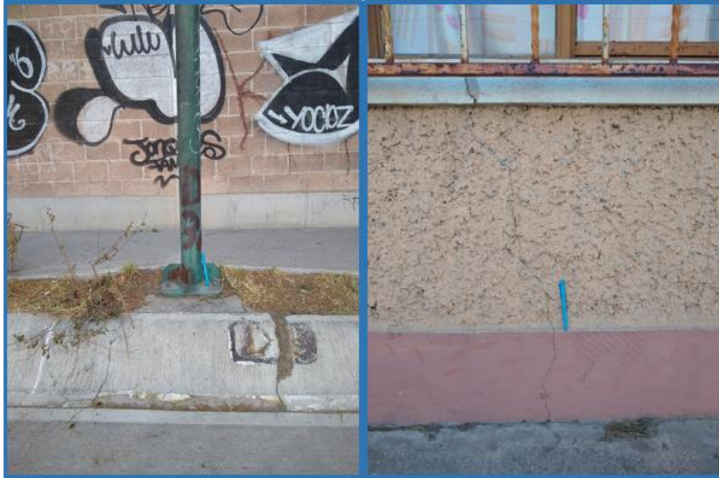
Figura 76. Grietas en inmuebles, zona de subsidencia en la Privada el Sauzalito.
