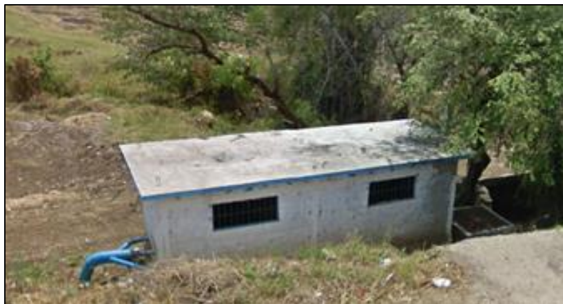
Figura 3.18. Caseta de bombeo aguas residuales localidad de Tamasopo.
