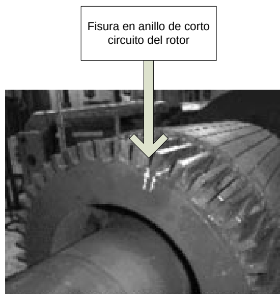
Figura 1.5. Fisura en anillo de cortocircuito de rotor en un motor de 8 polos de 900kW y 6kV [61].
