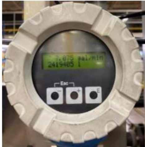
Figura 37. Flujómetro de suministro para el agua de fábrica #1 con una lectura de 7 gal/min a través de la tubería suministro de agua
