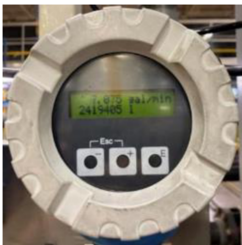
Figura 44 Flujómetro de suministro para el agua de fábrica #1 con una lectura de 7 gal/min a través de la tubería suministro de agua
