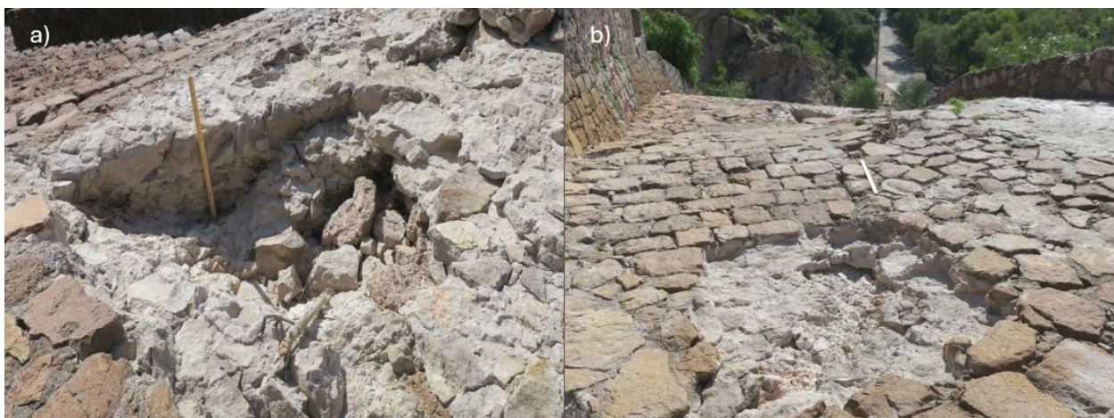
Figura 29. Socavones identificados en el vertedero de la margen izquierda
