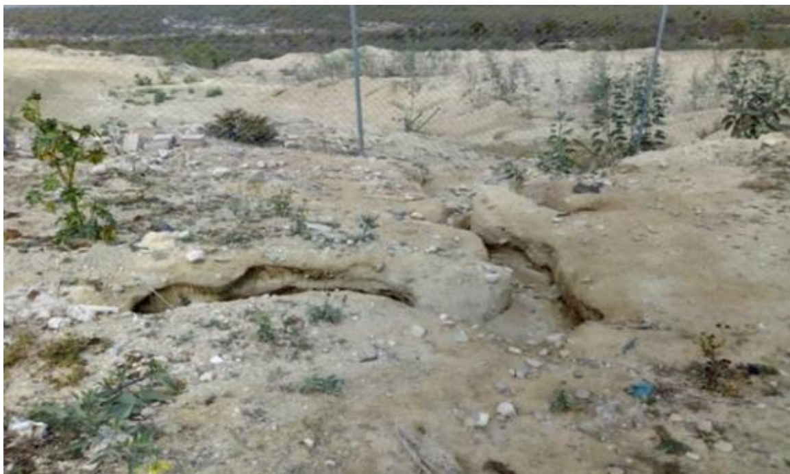
Figura 6.10 Grietas ocasionadas por la acción de agentes hídricos en la celda de contención de residuos.
