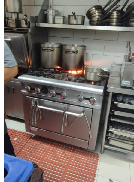
Figura 59: Ejemplo de utensilios mal posicionados en una cocina. Elaboración propia.
