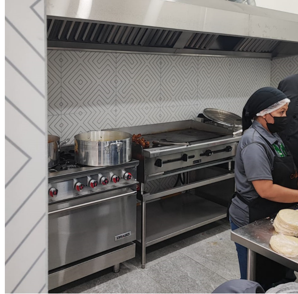
Figura 46: Plancha de una cocina industrial. Elaboración propia.
