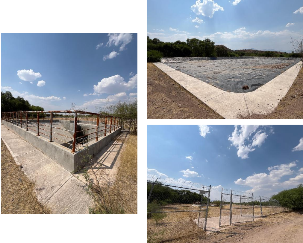
Figura 15. PTAR en Villa de Reyes.
