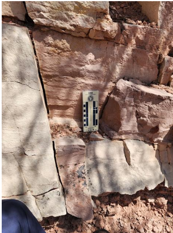
Figura 28. Afloramiento de tobas masivas con fracturación y alteración oxidativa. Sección de tobas masivas con textura consolidada y fracturación evidente, presenta tonalidades rosadas y beige, asociadas a procesos de oxidación y meteorización superficial. Las fracturas podrían estar asociadas a actividad tectónica.
